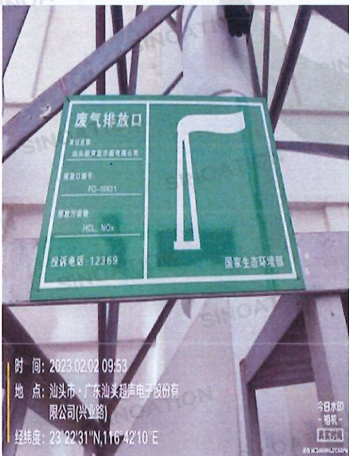
工艺废气排放口 (FQ-10831) 排污铭牌
